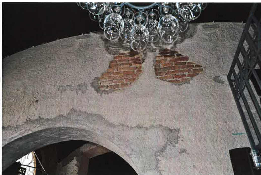
Căderea tencuiei și fomarea petelor din cauza umezelii (parter).
